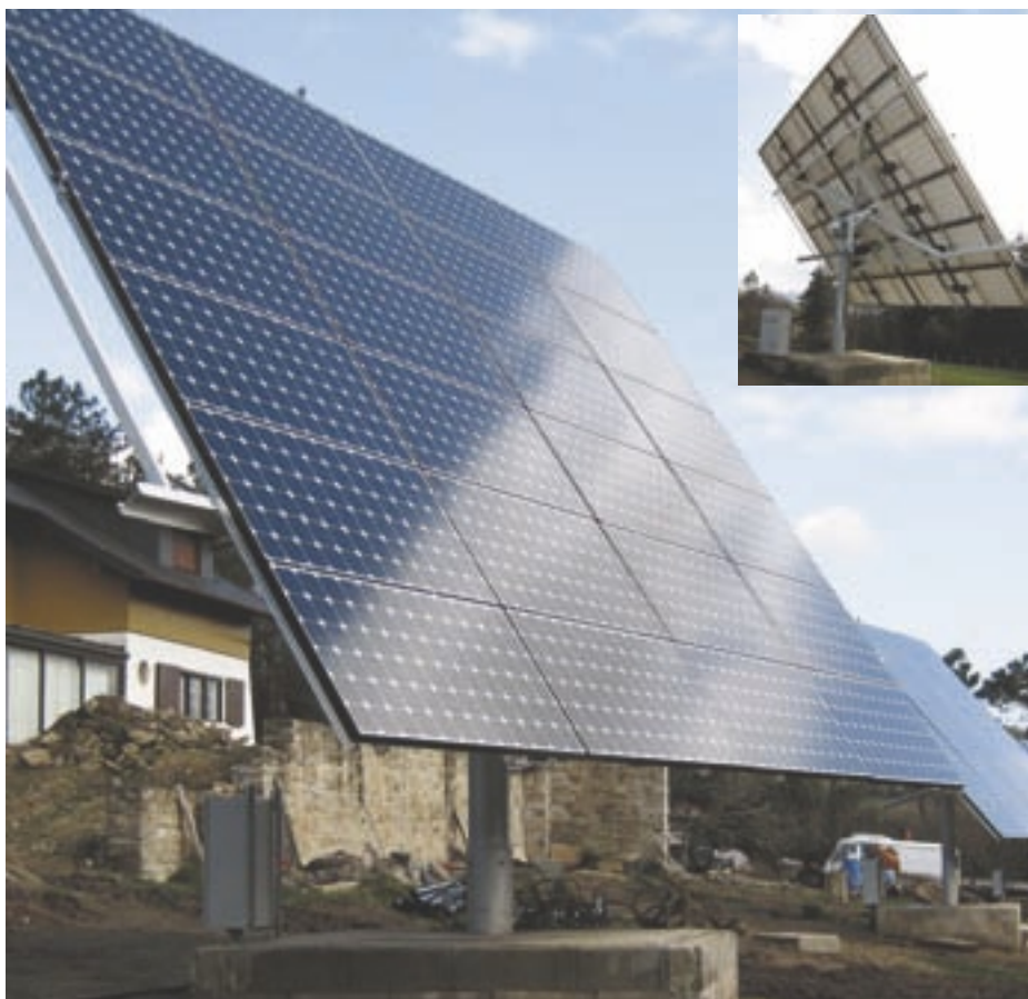
La ferme comporte 3 panneaux à concentrateur pour une puissance de 16 kWc installés à proximité de Mazamet dans le Tarn.
